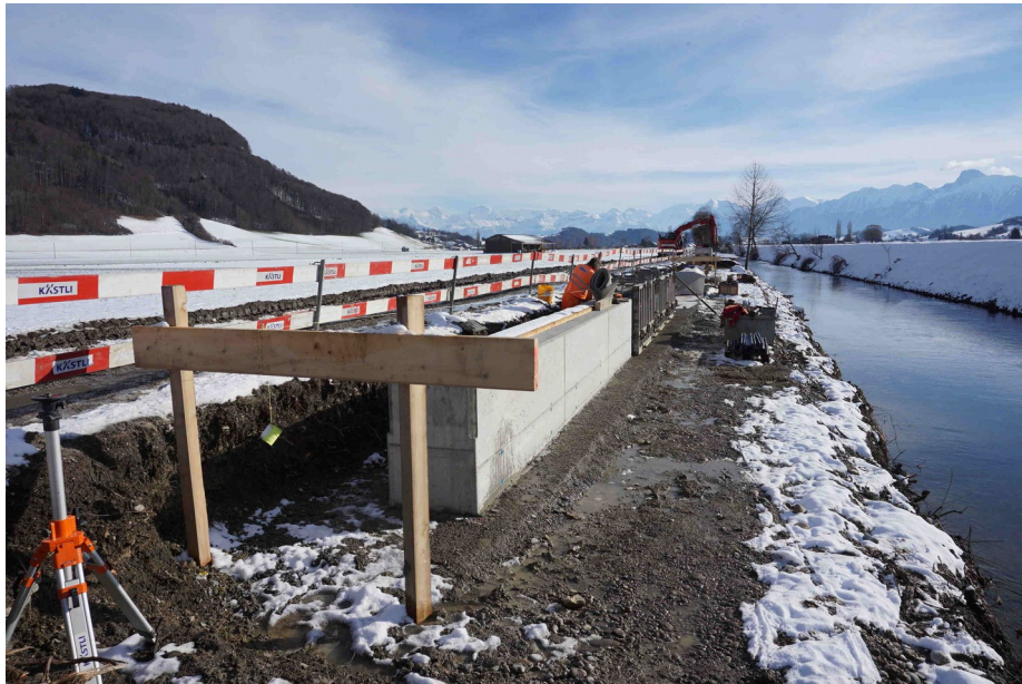
Streichwehr zum kontrollierten Ueberlaufen; die Höhe kann durch eingesteckte Elemente reguliert werden
